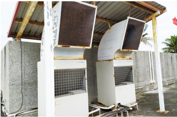
▲ 原機改善前現況
